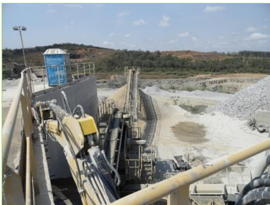
Figura 23: Vista da correia transportadora móvel a partir da área de abastecimento do britador primário.
