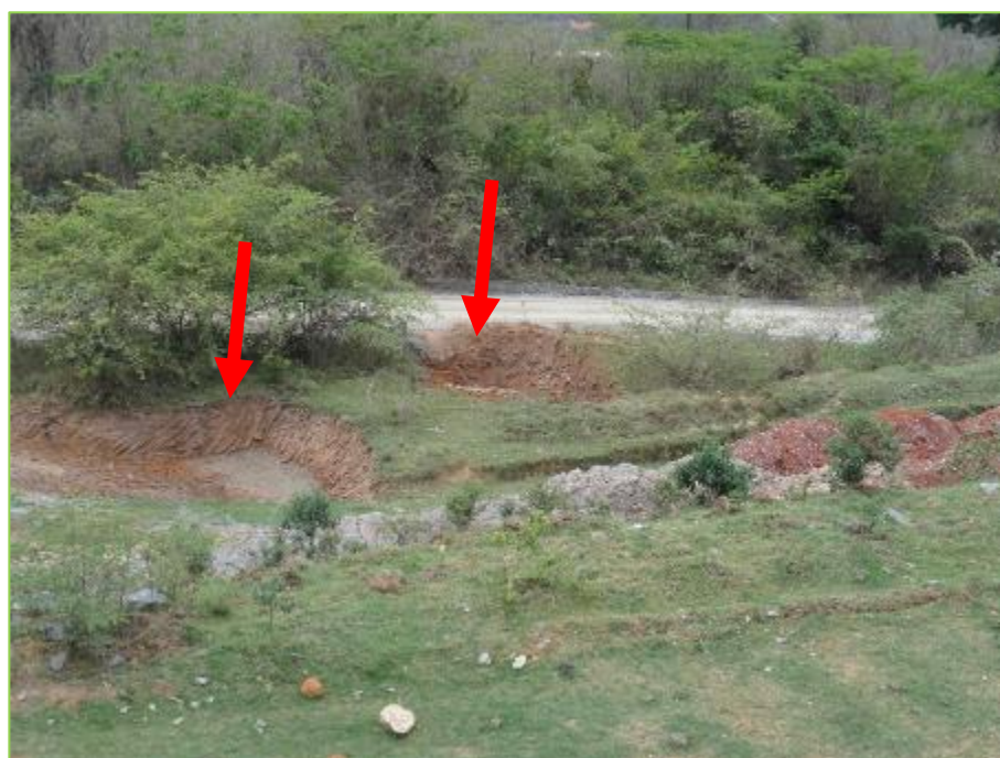
Figura 45: Exemplo de Sump's já existentes na Mineração para contenção de sedimentos, instalado a jusante da linha de drenagem pluvial (canaletas abertas em solo) do depósito controlado de estéril. Seta em vermelho com a indicação das estruturas.
