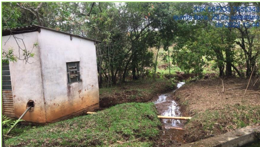
Figura 247: Casinha da bomba ao lado da nascente, que leva a água até o ponto mais alto do povoado.
