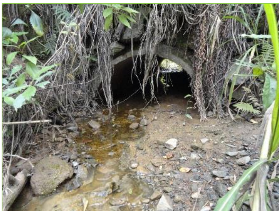
Figura 104: Bueiro que transpõem o fluxo pluvial da vala para a propriedade vizinha do empreendimento.
