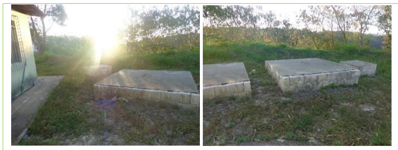
Figura 46: Fossa séptica que trata o efluente sanitário doméstico gerado na unidade Moinho da Mineração Barroso.
