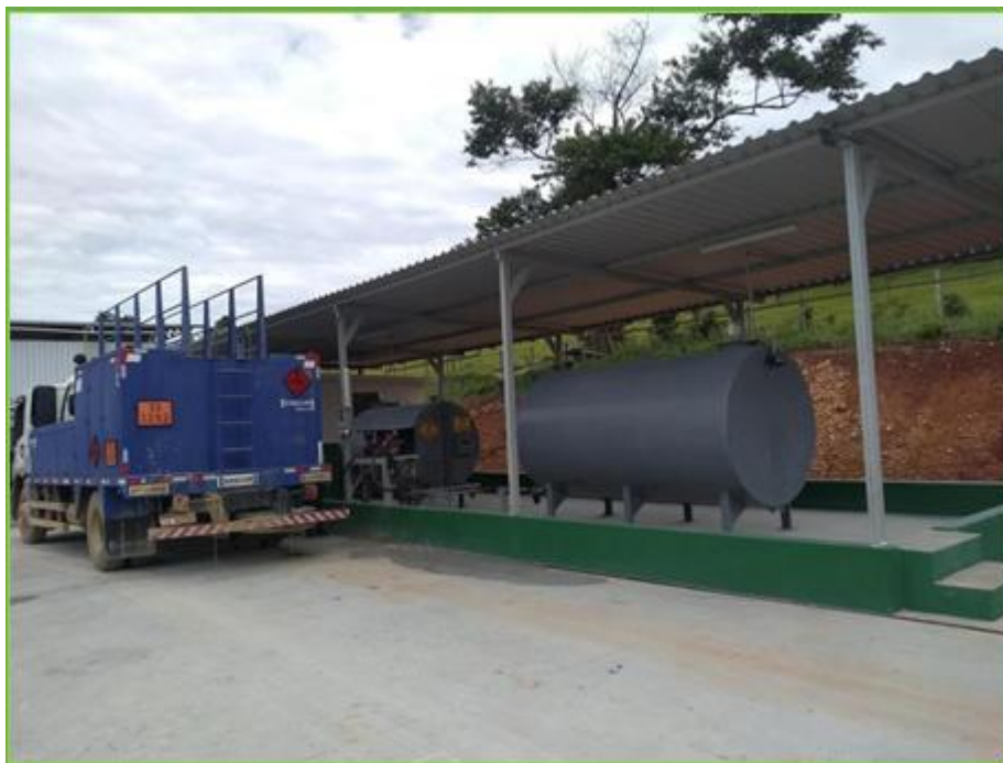
Figura 18: Posto de abastecimento de combustíveis, com pista de abastecimento e descarregamento em concreto com calha de drenagem direcionada para caixa separadora de água e óleo. Tanques de 15.000 litros instalados segundo as normas técnicas da ABNT.
