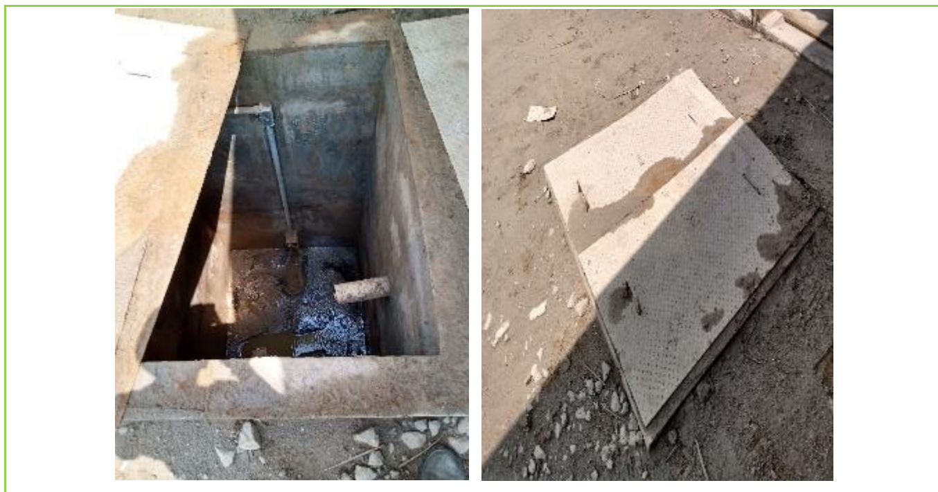
Figura 37: Caixa desarenadora instalada antes da Caixa Separadora de Água e Óleo com o objetivo de reter os sólidos que poderiam prejudicar o bom funcionamento.
