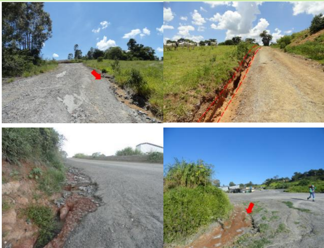
Figura 65: Processos erosivos laminares e lineares formados pela exposição do solo ao longo de acessos e trilhas no interior da área da Mineração Barroso. Tais porções de terreno deverão ser alvos de preocupação ao longo da operação do projeto minerário, devido a sua maior probabilidade de carrear sedimentos à jusante, onde flui os cursos d'água da bacia hidrográfica do Rio Elvas e pela eventual evolução das mesmas.
