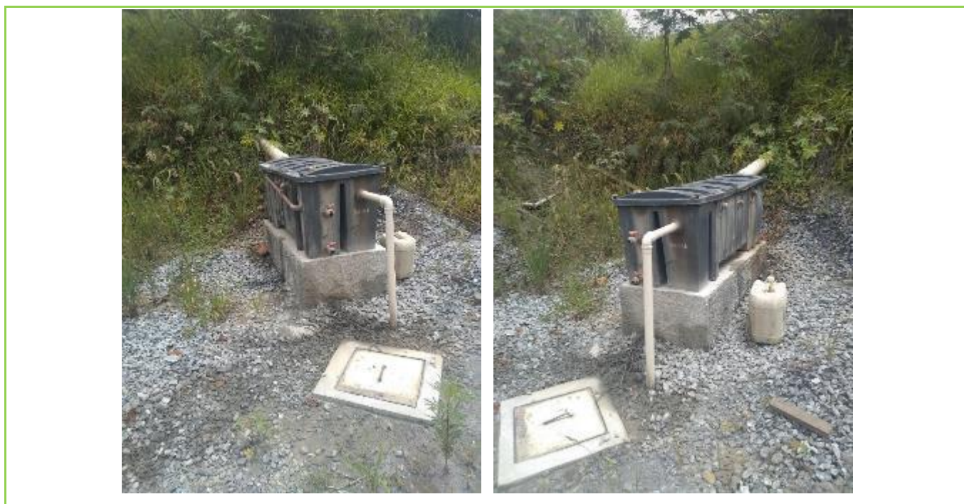
Figura 38: Caixa separadora de água e óleo instalada no empreendimento.
