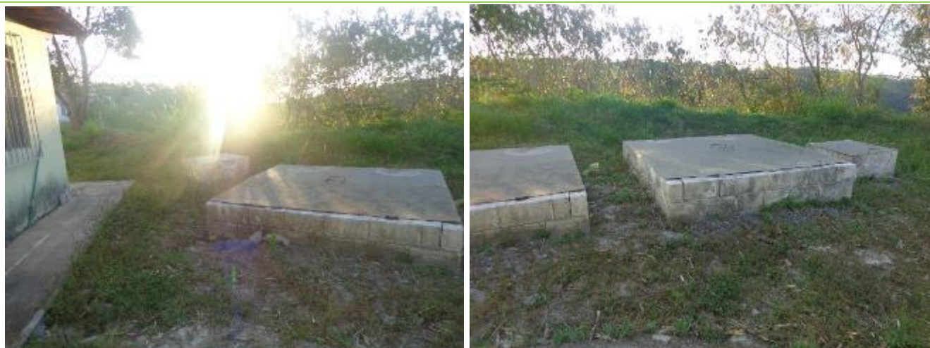
Figura 35: Fossa séptica que trata o efluente sanitário doméstico gerado na unidade Moinho da Mineração Barroso.
