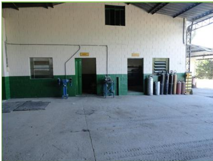
Figura 16: Sala de manutenções mecânicas (a direita) e sala de manutenções elétricas (a esquerda) ambas as estruturas com solo impermeabilizado.
