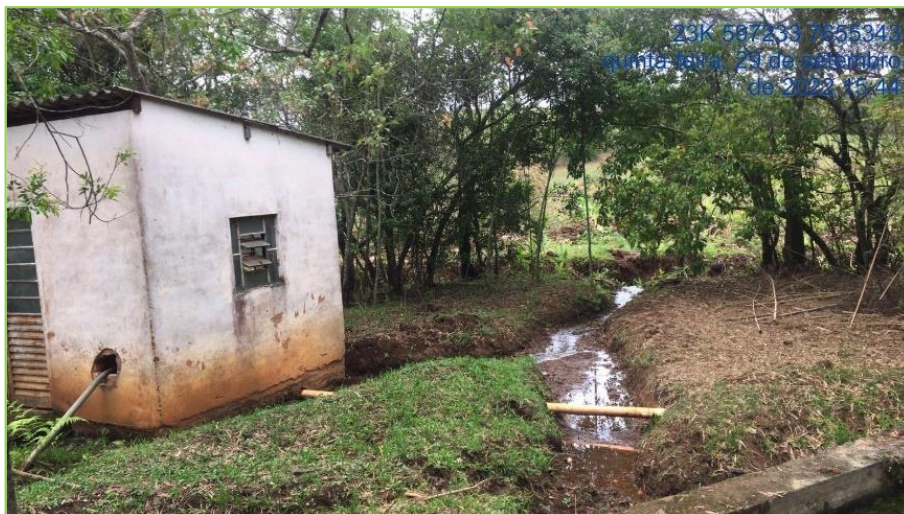
Figura 223: Casinha da bomba ao lado da nascente, que leva a água até o ponto mais alto do povoado.
