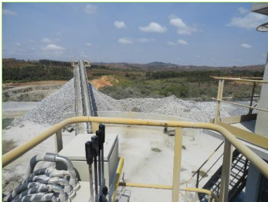
Figura 22: Vista da correia transportadora móvel a partir da área de abastecimento do britador primário.
